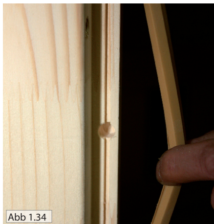
Türdichtung von Glastüre.
